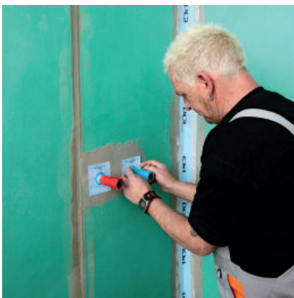
...nachfolgend die Dichtmanschette vorsichtig über den Stopfen, auf das Verlängerungsstück gezogen und in die frische Abdichtung einbetten.
