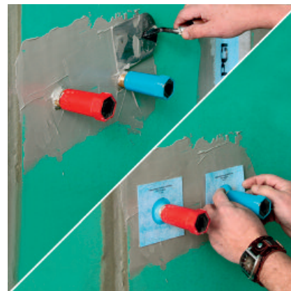
2c. Auch zum Abdichten der Wasserzuleitungen mit der Dichtmanschette PCI Pectape 10 x 10 wird zunächst ausreichend viel Abdichtungsmaterial PCI Lastogum vorgelegt. 2d. PCI Pectape 10 x 10 über den aus der Wand herausstehenden Rohranschluss stülpen und mit PCI Lastogum verkleben.
