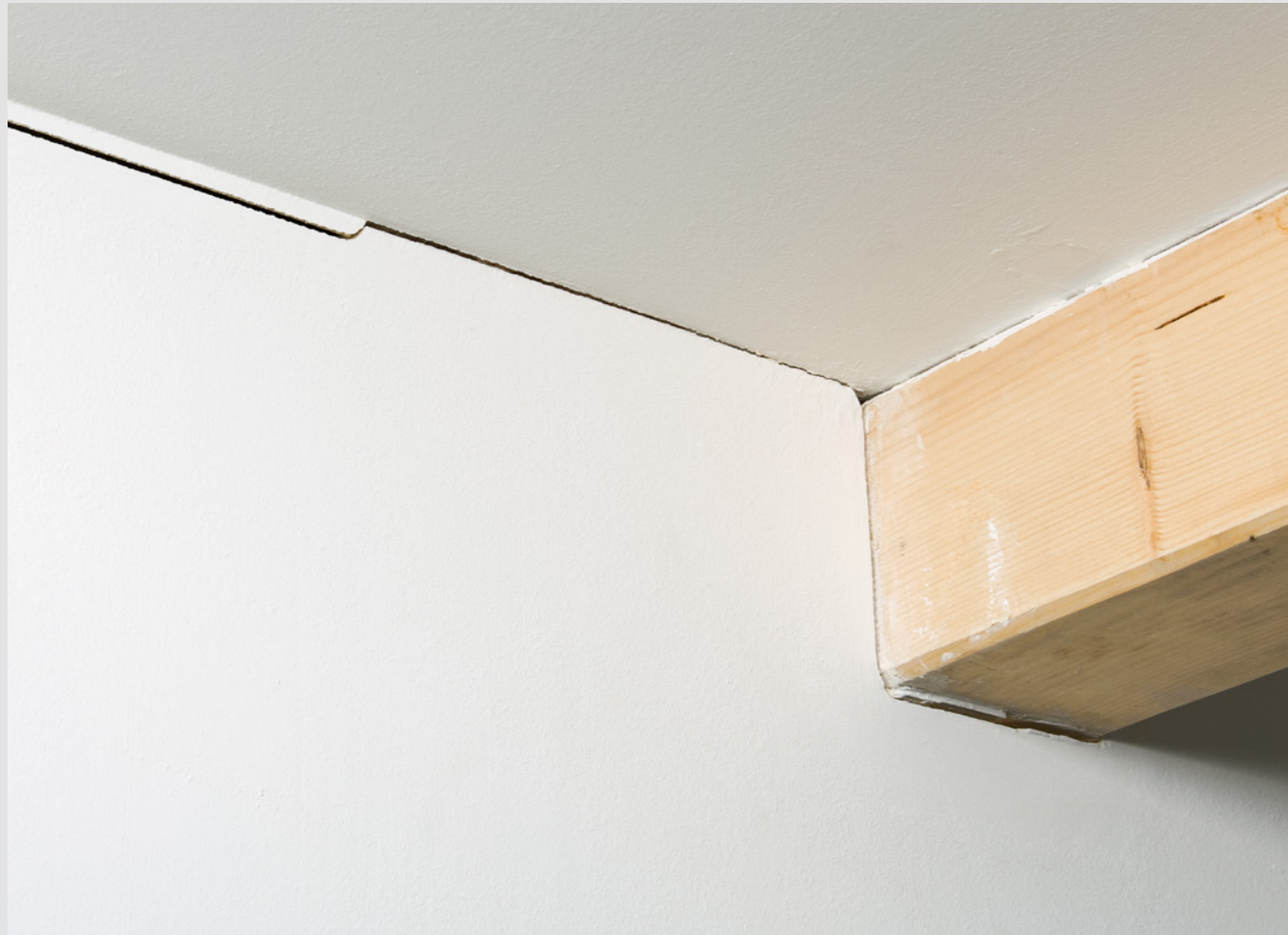
Überspringender Riss aufgrund fehlender Bauteiltrennung
