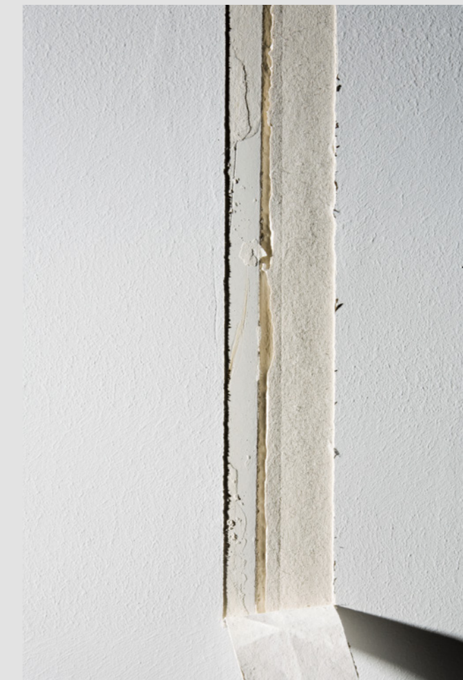
Ursache: zu wenig Spachtelmaterial unter dem Fugendeckstreifen auf der SK-Seite (links der Fugenmitte)
