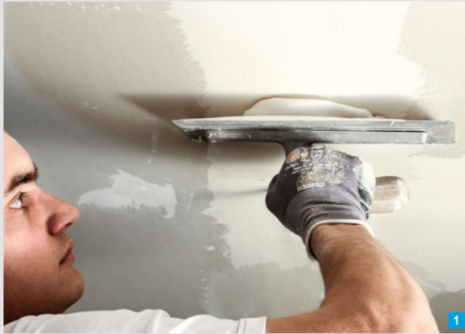
Der manuelle Spachtelauftrag kann nicht nur mit der Glättkelle, sondern auch mit einer langflorigen Lammfellrolle erfolgen.
