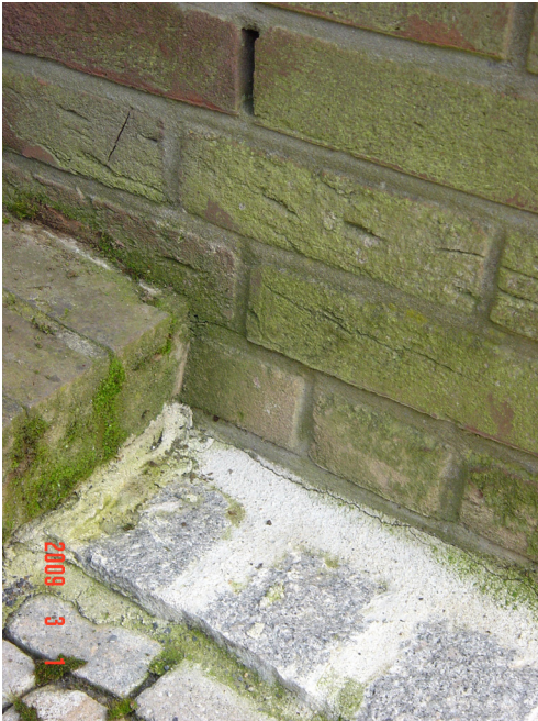
Sichtmauerwerk mit Vergrünung
